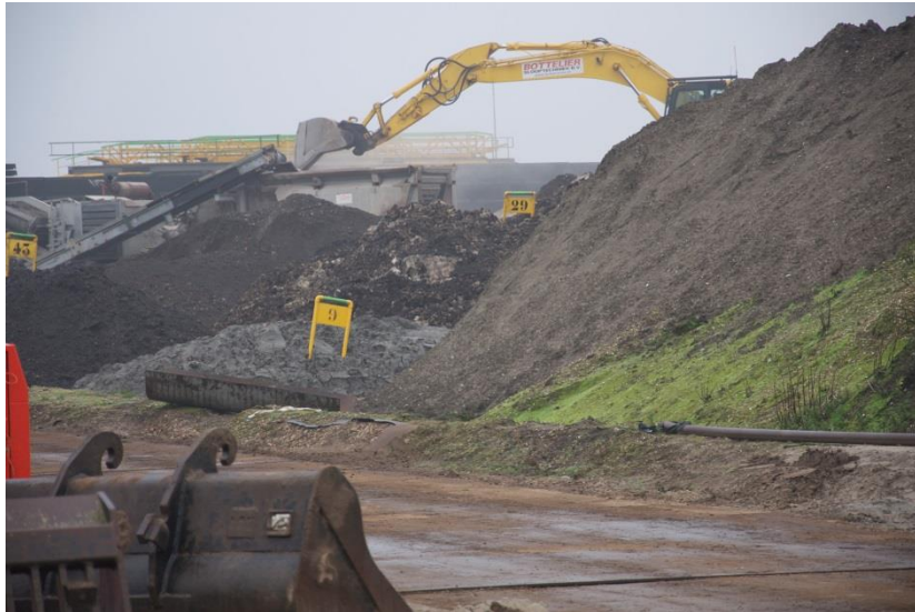
Foto: risico op energieoverslag.
