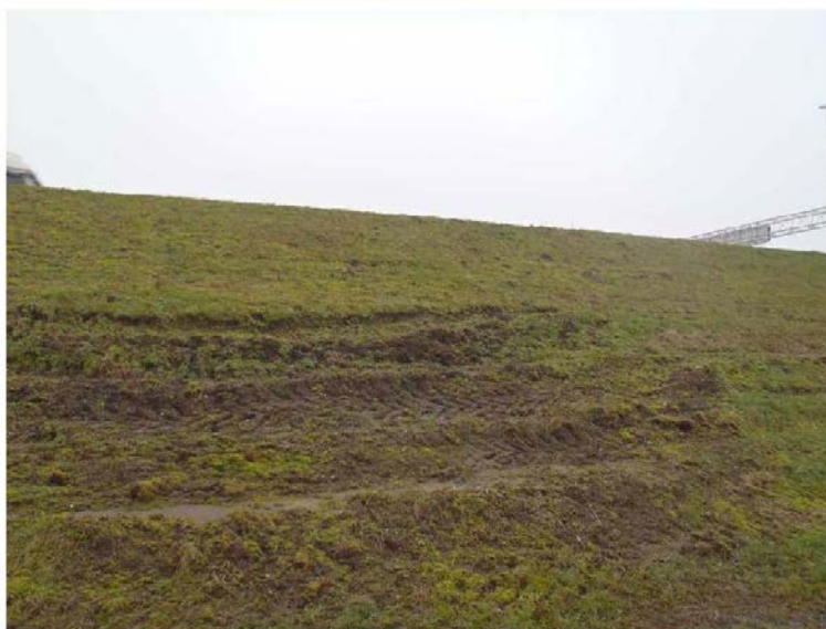
Foto: Maaischade aan afdeklaag.
