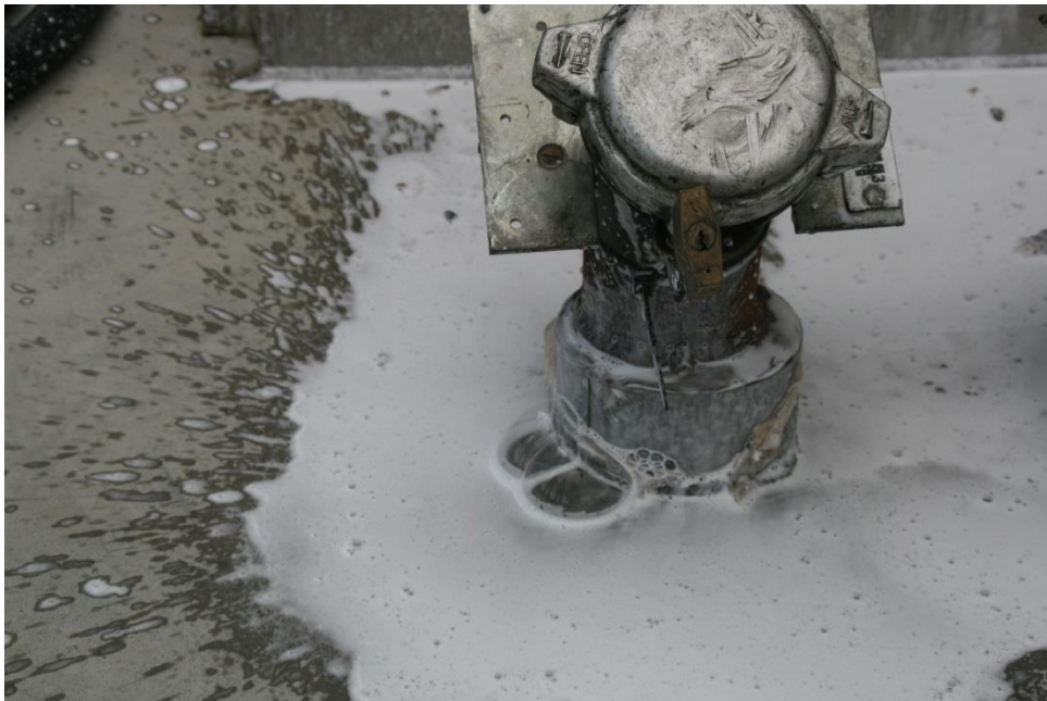
Foto: Luchtlekage bij doorvoer.
