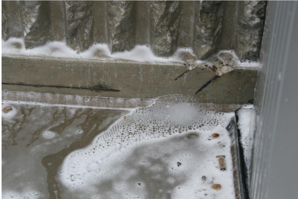
Foto: Luchtlekkage bij aansluiting.
