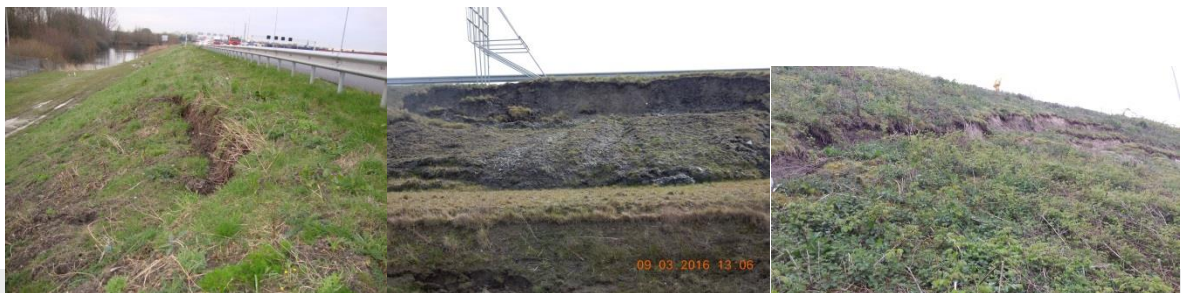
Foto: Afschuiving van talud.
