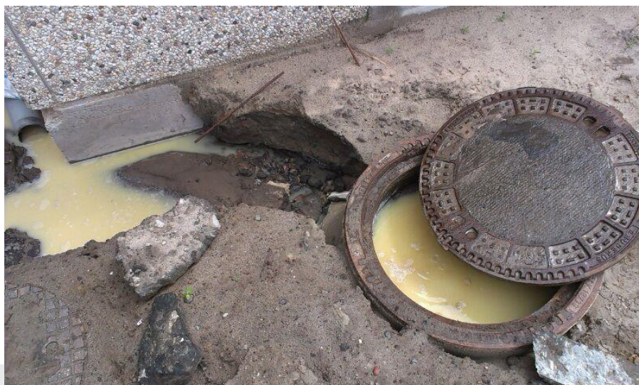
Foto: Verzakking ter plaatse van riolering.
