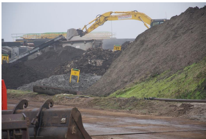
Foto: Risico op energieoverslag.
