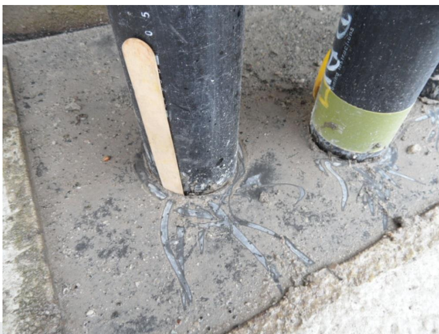
Foto: Voorbeeld van een niet-afgedichte doorvoer.
