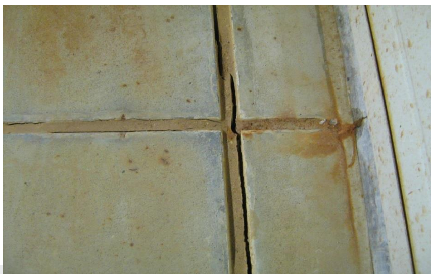
Foto: Beschadigde kitvoeg.
