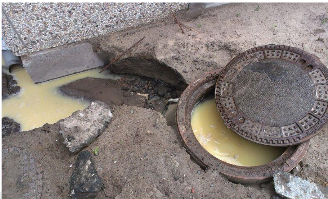
Foto: Verzakking in het rioleringssysteem.
